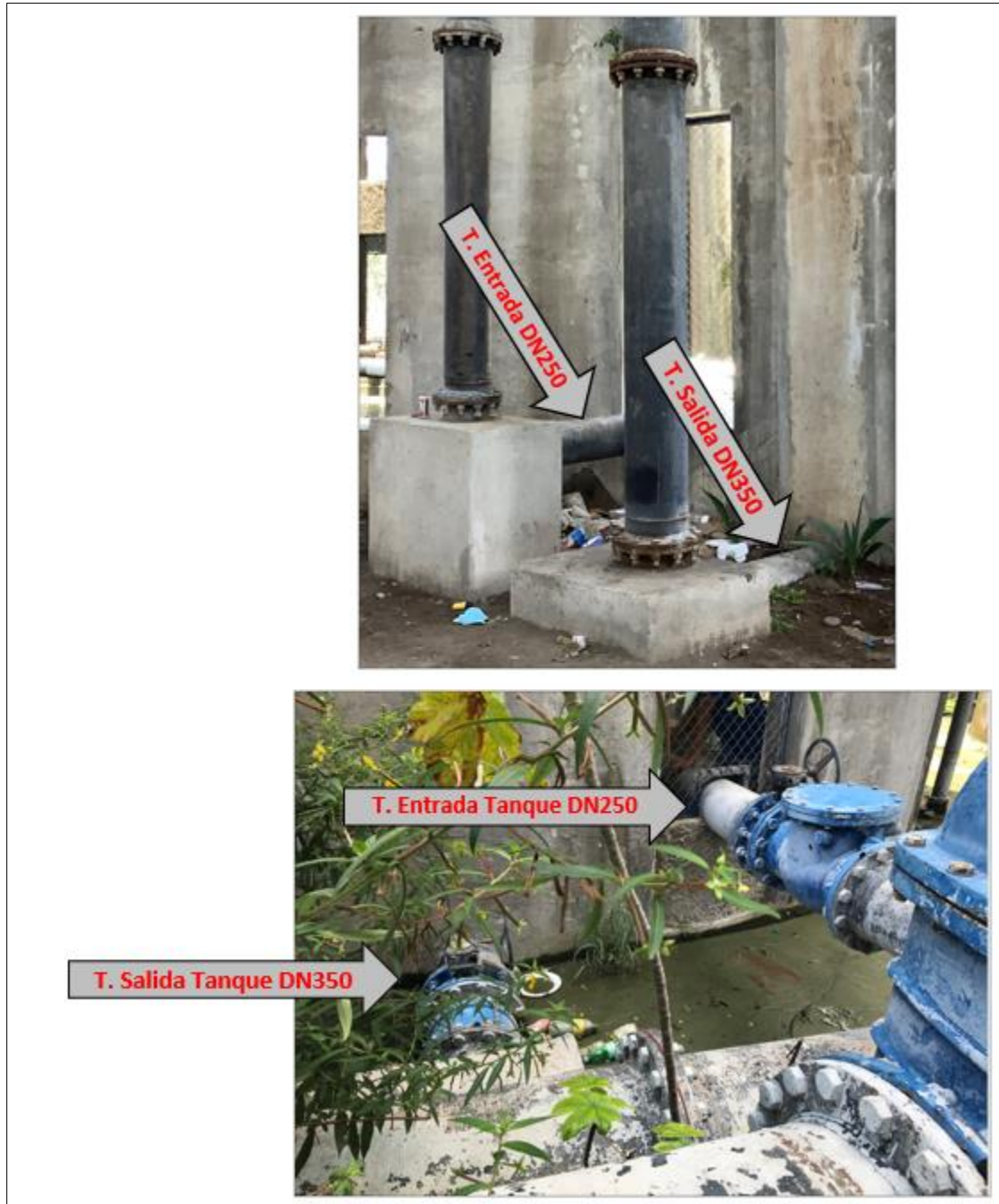
Figura 4. Tubería de entrada y salida existente en el tanque #2.
