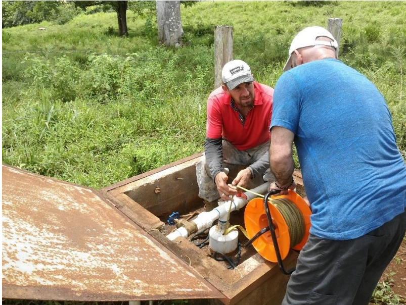
Fotografía 2: Vista del pozo utilizado por la Asociación de Desarrollo Integral de Llano Verde de Pocosol para suministrar agua a la comunidad. Coordenadas 319,782 Norte y 493,722 Este (Proyección Lambert Costa Rica Norte).
