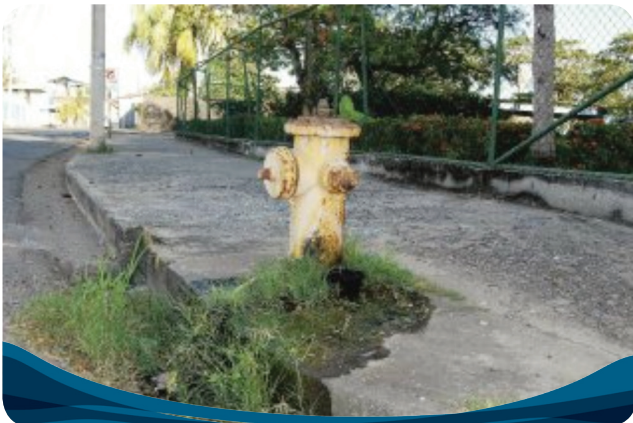
Muestra el abandono de hidrantes. Tomada de www.nacion.com 27/02/2008.
