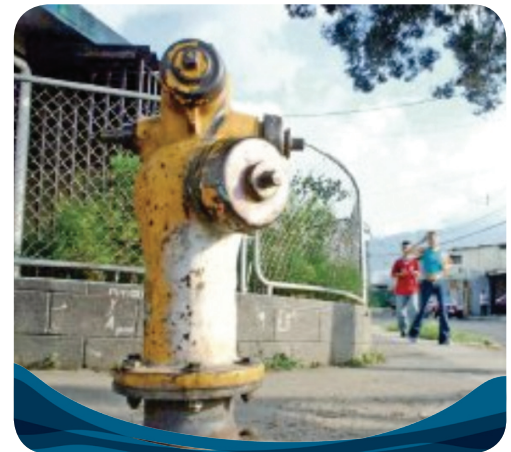
Denota la antigüedad y falta de mantenimiento. Tomada de www.nacion.com 15/11/2007.
