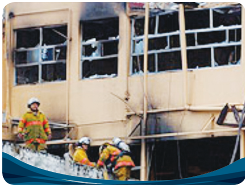
Después del incendio, Hospital Calderón Guardia, San José. Tomado de www.bbcmundo.com 12/07/2005.
