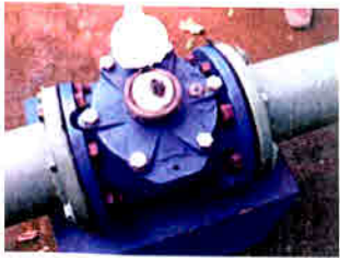
Macromedidor Pozo #2, Papagayo Norte
