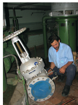
Estación de Bombeo en las fuentes de Puente de Mulas
